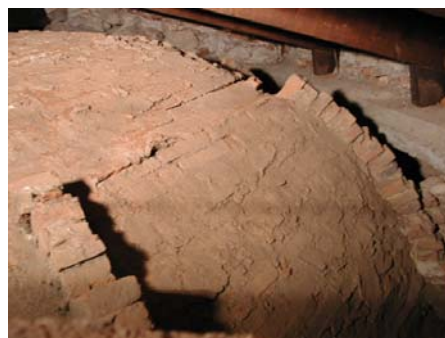
Figura 3. Vista estradossale della cupola fessurata.
