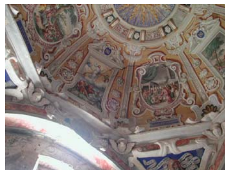
Figura 2. Vista intradossale della cupola fessurata.
