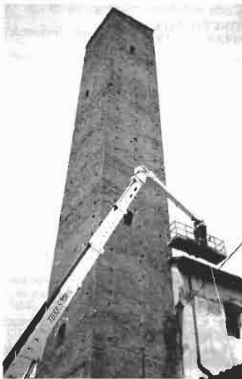
Fig.1 - La torre come si presenta oggi, al termine degli interventi di consolidamento, senza alcun elemento esterno tranne la gabbia di Faraday, installata in sommità.
