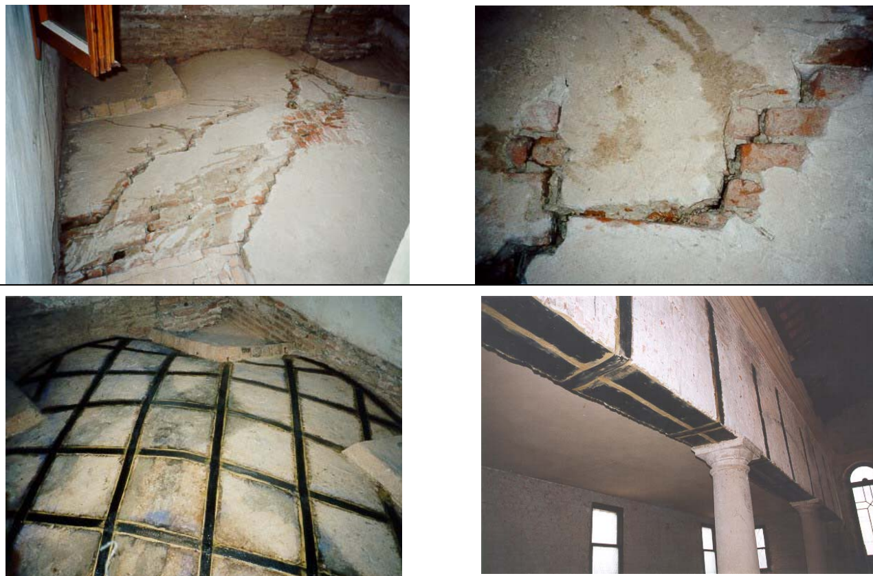
Figure 8 a,b,c,d I danni riscontrabili sulle volte ed il restauro strutturale realizzato utilizzando materiali fibrorinforzati
