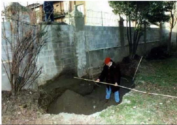
Figura 10 Scavernamenti e cedimenti diffusi del terreno nelle zone prossime al cantiere
