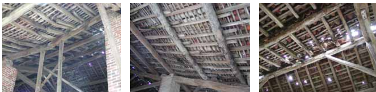
Figura 3. a) Rottura di una terza lignea; b) Forte inflessione delle terzere e dei travetti secondari; c) Sconnessione del manto di copertura e degrado degli elementi strutturali.
