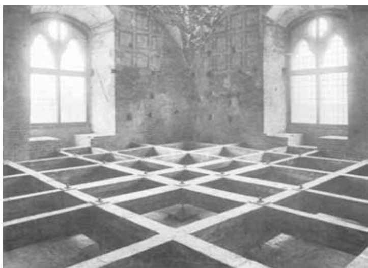
Figura 1. Consolidamento della volta, progettato da Annoni (1925), tramite grigliato in c.a. I forti carichi permanenti hanno dato origine a fenomeni di cedimento viscoso
