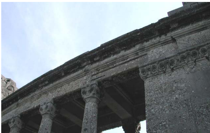
Fig. 7 – Scorcio del prospetto nord: rinforzo di una architrave fratturata mediante applicazione di fasce di ferro.
