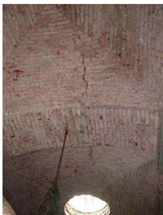
Fig. 2 – Lesione continua attraverso le volte e gli archi di sostegno.
