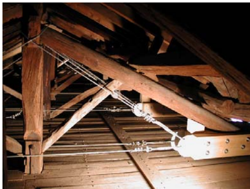
Figura 7 Ex monastero di S. Clara, Pavia: consolidamento mediante cavi esterni post tesati e “bilancini” in legno lamellare appoggiati sulla muratura
