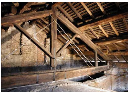
Figura 5 Ex Chiesa di S.Carpoforo, Milano: consolidamento degli appoggi e delle capriate mediante cavi esterni post tesati, con inserimento di un nuovo puntello ligneo di contrasto della falda.
