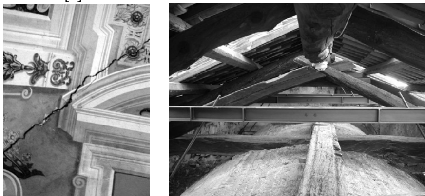
Fig. 7: Una evidente fessura sulla volta del Corridoio delle Grottesche; Realizzazione della “graffetta” all'estradosso della volta
