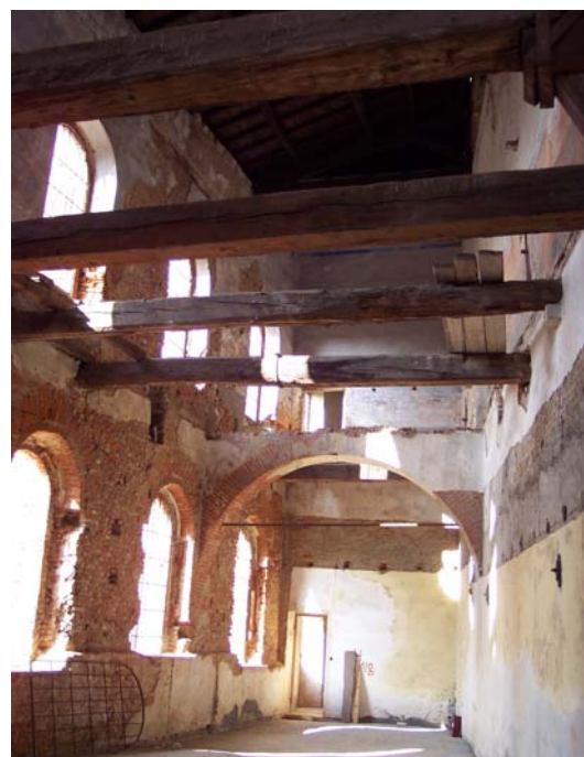
Figura 7. Stato di conservazione di alcuni solai interni prima degli interventi.
