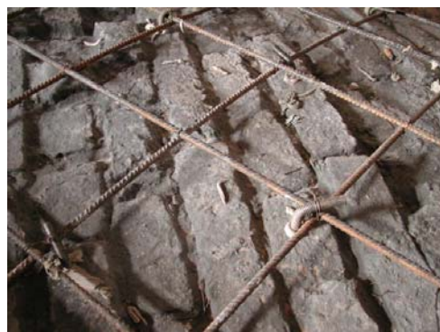
Figura 3. Dettaglio dell'ancoraggio della rete elettrosaldata alla volta, realizzato mediante ferri sagomati ad "L" ed inghisati.
