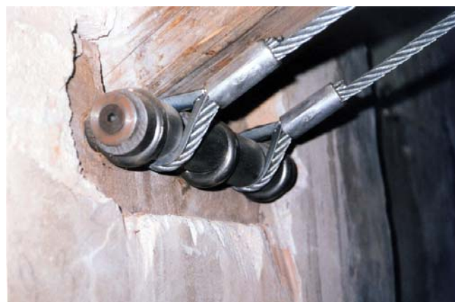
Figura 2. Attacco dei cavi metallici alle imposte dei puntone delle capriate.
