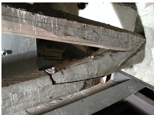
Figura 2. Ammaloramento degli appoggi delle capriate.
