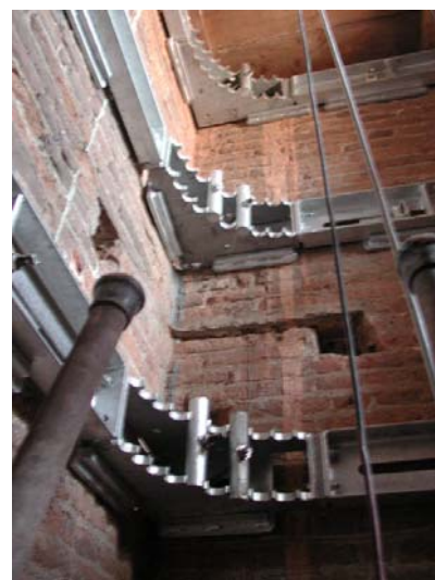
Figura 4. Catene metalliche interne con cremagliera per il montacarichi.
