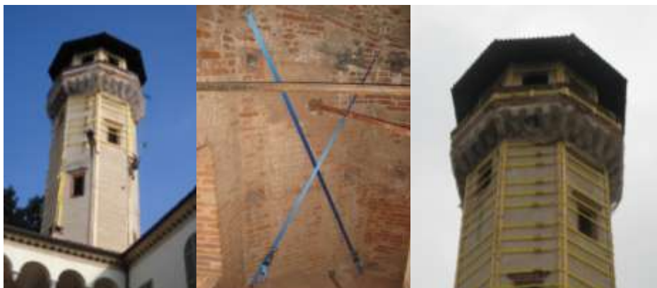
Figura 21. Opera di messa in sicurezza mediante fasce in poliestere presso la Torre dei Masserano a Biella (Jurina 2012)
