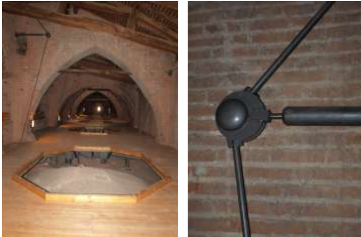
Figura 10. Duomo di Cremona: variante della tecnica dell'“arco armato”, in grado di applicare forze orizzontali all'imposta degli archi.
